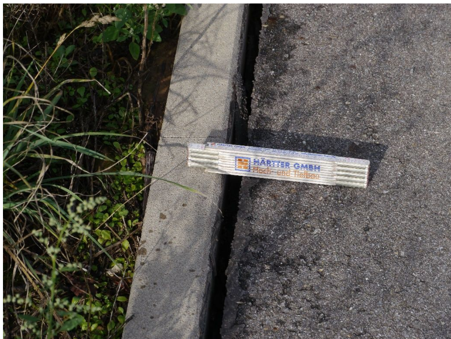
Bild 10: Betzenbergstraße, bestehender Südteil der Ringstraße: durch Untergrundschrumpfung talseitiger Randsteinsatz vom Gehweg abgerissen.
