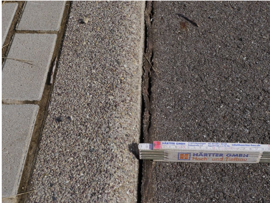
Bild 9: Betzenbergstraße, Westseite unterhalb BK 2: durch Untergrundschrumpfung abgelöster Randsteinsatz.
